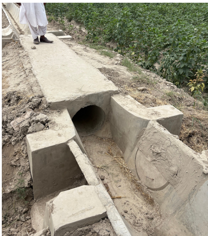
灌漑用水路の分岐点：左右の蓋を開け閉めして、 田畑に水を流し込みます ©CWS JAPAN
