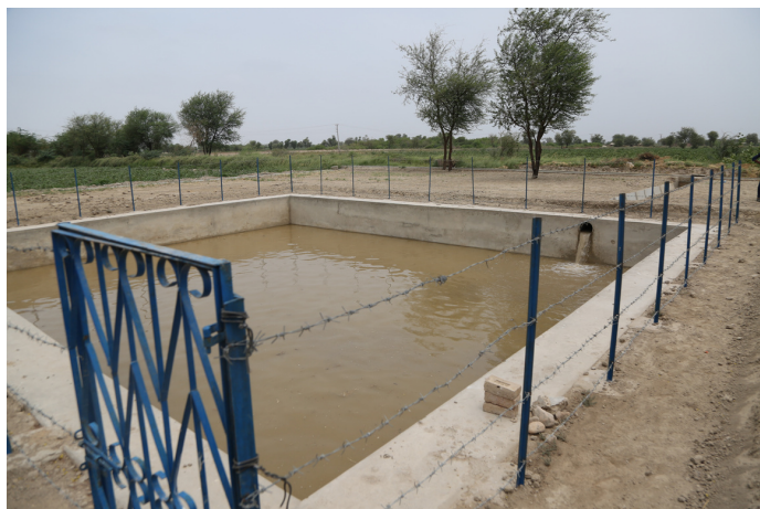
貯水池：水路を流れてきた水が貯められていく様子を見ることができました ©CWS JAPAN
