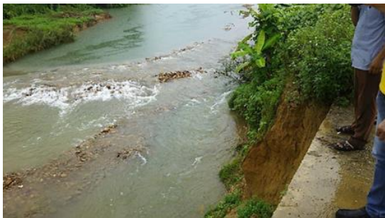
洪水により浸食されている主要道路
