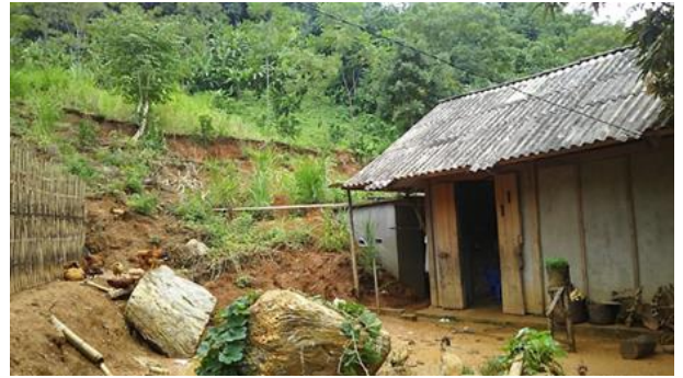
裏手の山が崩れて一部が土砂に埋もれた家
